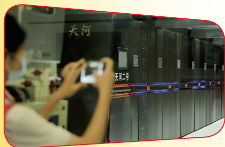
▲参观“天河二号”主机房
