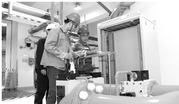
>> 抽水蓄能电站具有调峰、填谷、调频、储能、事故备用等多重功能。图为2021年11月16日，安徽响水涧抽水蓄能电站工作人员在调试设备 刘军喜/摄
