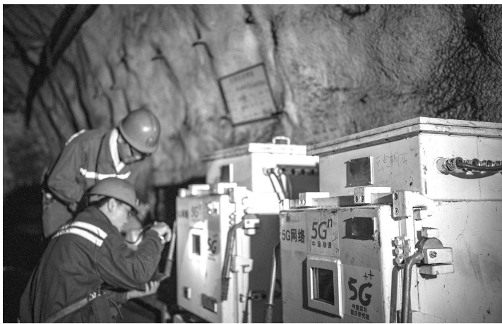
>> 贵州盘江精煤股份有限公司山脚树矿工作人员在井下检查5G基站控制器运行情况 陶亮/摄
