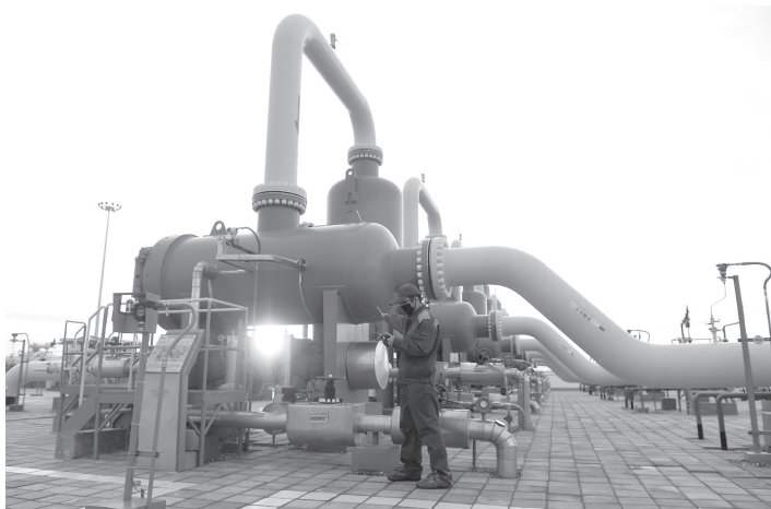
>> 中亚天然气管道霍尔果斯计量站，工作人员正在巡检
