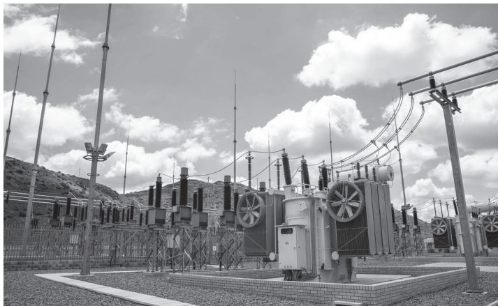
>> 南非北开普省德阿镇，中国龙源电力集团南非公司运营的德阿风电项目设备 吕天然 / 摄
