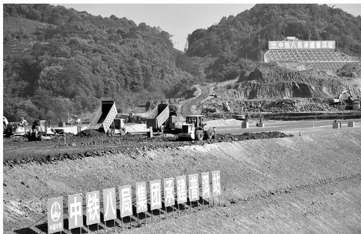
>> 中老铁路2016年12月开工，2017年年中开始全面施工，计划在2021年底前建成通车。中老铁路是融入国家共建“一带一路”倡议，推进中国—东盟自由贸易区建设的重要基础设施，更是首条以中方为主投资建设、中老共同运营并与中国铁路网直接连通的国际铁路。图为中老铁路国内段普洱车站施工现场 秦晴/摄
