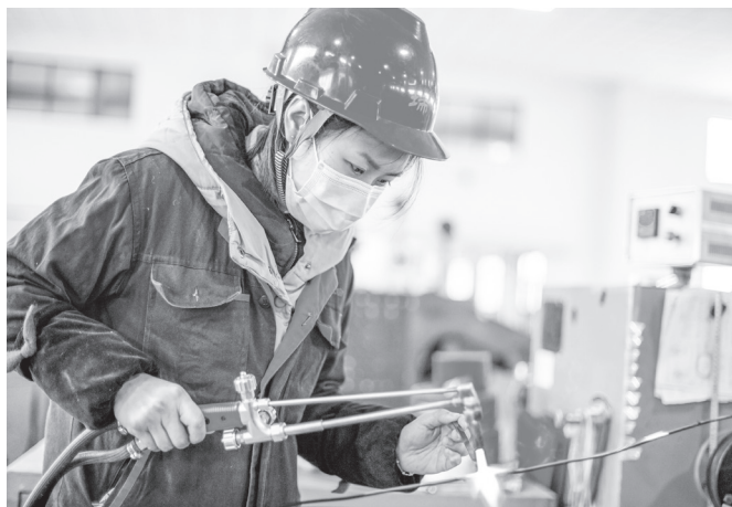
>> 2021年1月4日，江苏省海安高新区瑞恩电气生产车间内，工人正在赶制供应国内外市场的干式变压器 翟慧勇/摄
