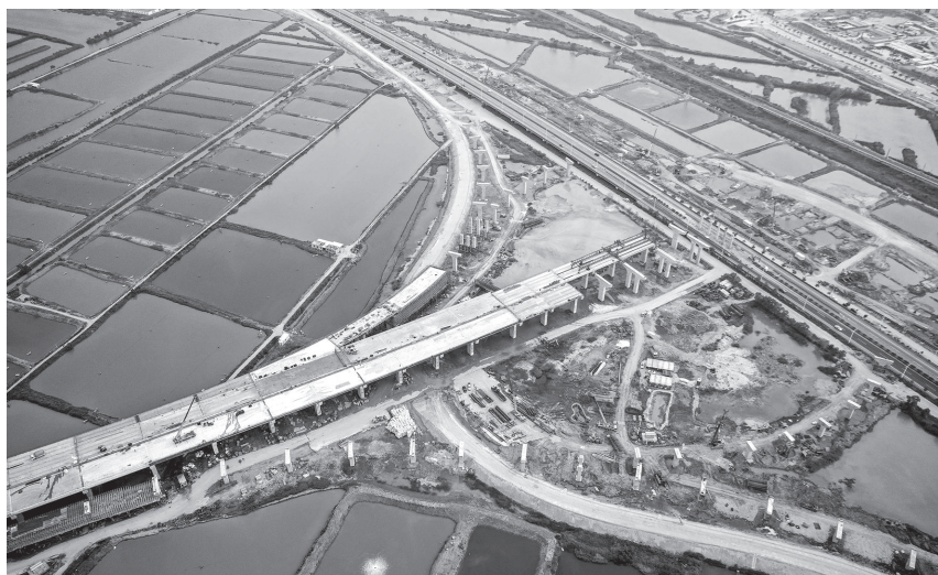
>> 近日，珠海鹤港高速公路二期工程高栏港枢纽立交桥正加紧施工。鹤港高速全长35公里，全线设置7处互通立交、18座特大桥和大桥、2座隧道，项目建成后将成为珠江口西岸地区快速对接粤港澳大湾区核心区域的主通道 刘大伟/摄
