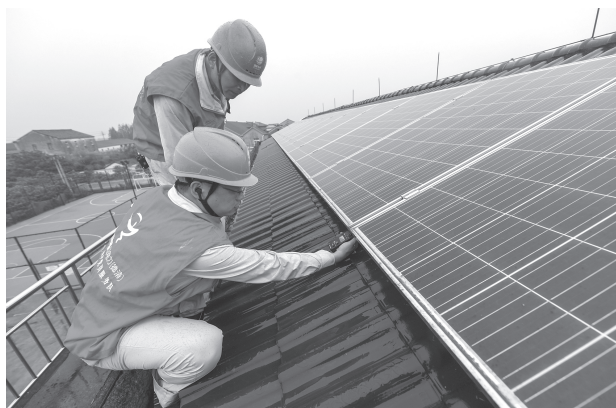
>> 浙江省德清县推进光伏板并网发电，并上线清洁能源消纳调控平台，实现区域碳排放分析等数据的智能化应用。图为工作人员检查光伏板并网发电情况 徐昱/摄
