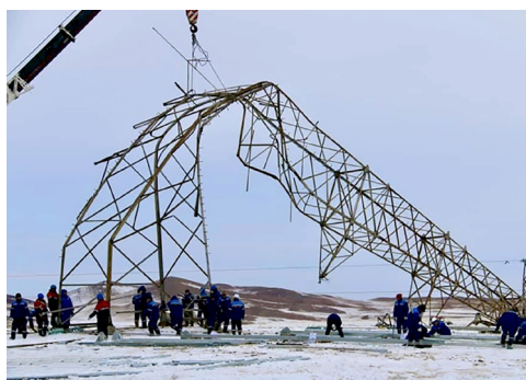
2021年3月14日，蒙古国中戈壁省遭受强沙尘暴袭击。图为被沙尘暴损坏的供电设施 央视总台/发
