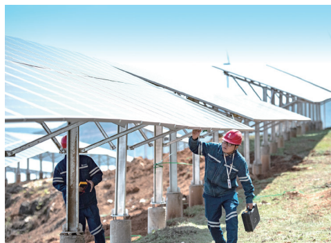
贵州金元集团工作人员对斗古瓦厂光伏发电板进行巡检 陶亮/摄
