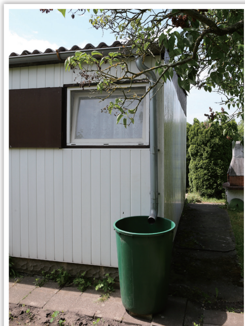
德国柏林一户人家屋外的雨水收集设施 新华社/供图
