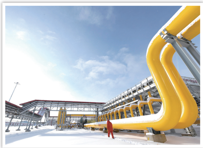
中俄东线天然气管道北段黑河首站场区 王建威/摄
