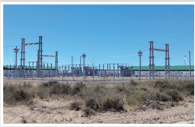
2021年1月22日，在阿根廷玛德琳港拍摄的由中企投资承建的罗马布兰卡风电项目一期和三期变电站 新华社/发
